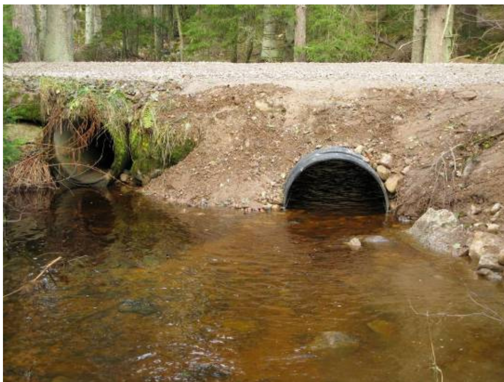
Figur 8. Exempel på vägtrumma (800 mm) med naturlig botten där den ursprungliga trumman lämnats kvar för att avbörda vid ev. högflöde. Foto: T.Nydén
