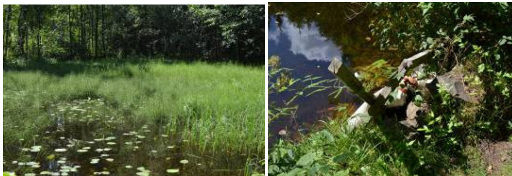
Figur 7. Damm i bäcken som är kraftigt igenväxt och utgör ett definitivt vandringshinder. Figur 8. Dammens utskov, enkel spetlucka tätad med dukar. Foto: P. Johansson.
