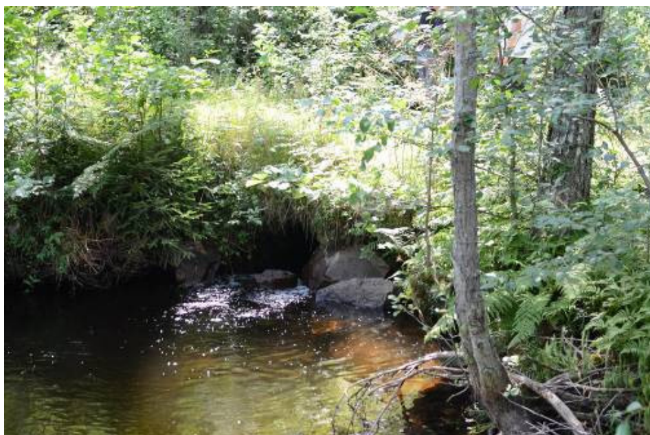
Figur 27. Ett kort stycke upp från Örken finns en vägtrumma som utgör ett svårpasserbart vandringshinder. Föreslås att en ny plasttrumma placeras bredvid, utan fall och som medger ett konstant vattendjup. Foto: P. Johansson.
