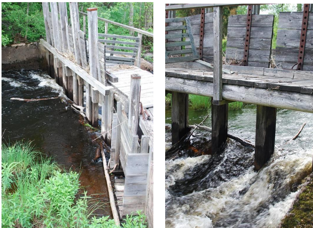
Figur 35 Sågdammen, trärännan med spetlucka ses i förgrunden. Smalt mellan trästolparna vilket snabbt samlar på sig skräp.
