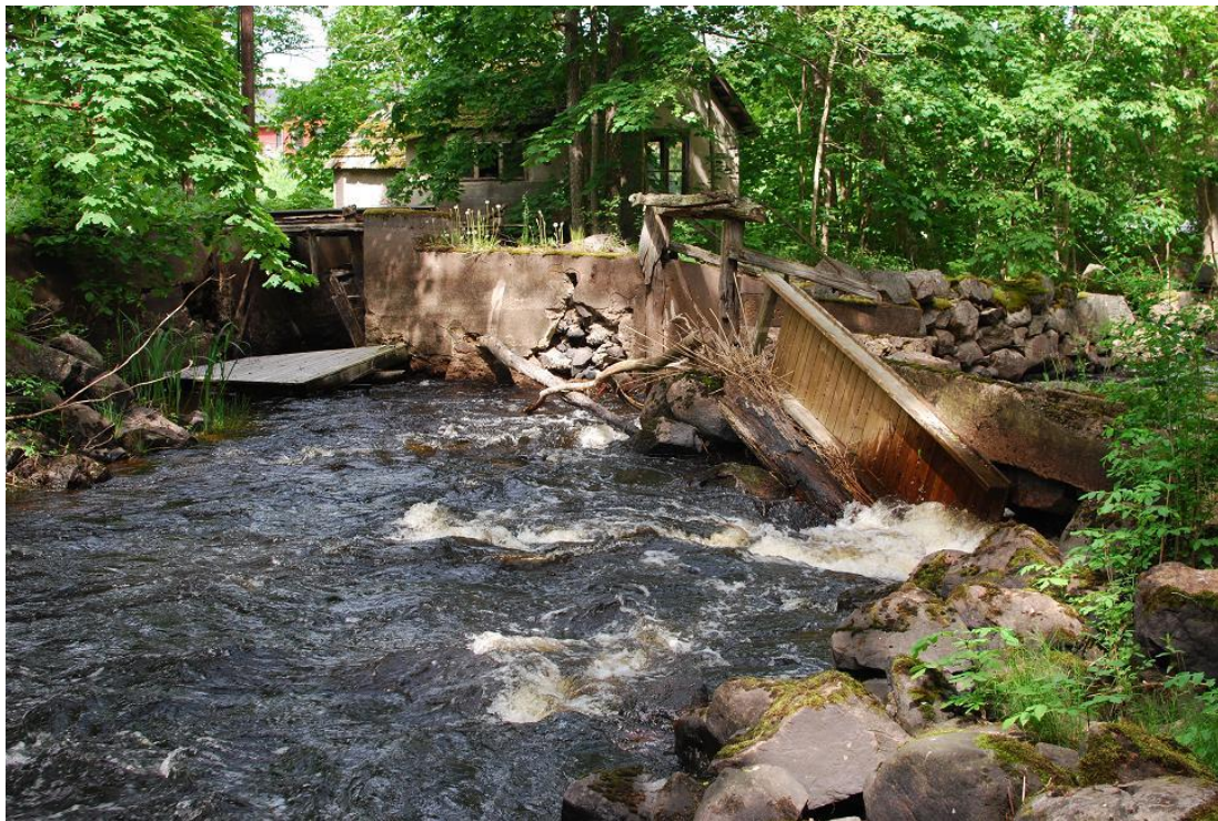
Figur 26. Vy över lokal 3C, Virkvarn som visar rester efter äldre kvarn och senare kraftverk. Hela anläggningen är förfallen. Foto: P. Johansson.
