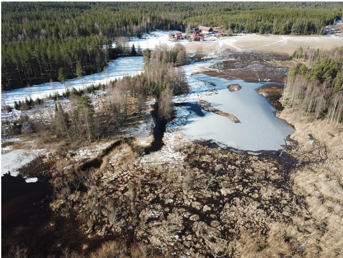
Figur 10. Sjöyta och svämplan/våtmark är nästan färdigställt i slutet av februari. Vid denna tiden började vårfloden i Fuseån och enligt SMHI hype rinner ca 3 m 3 /s.
