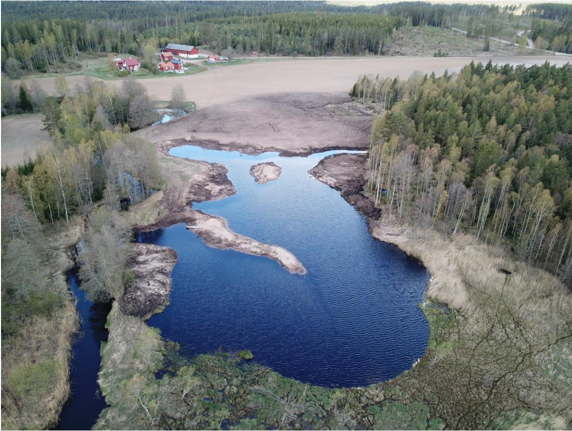
Figur 12. Bocksjön i början av maj 2019. All grävning är klar och större delen av schaktmassorna har jämnats ut. Samtidigt har vårflödet börjat sjunka, ca 1,5 m 3 /s rinner vid denna tiden enligt SMHI hype.
