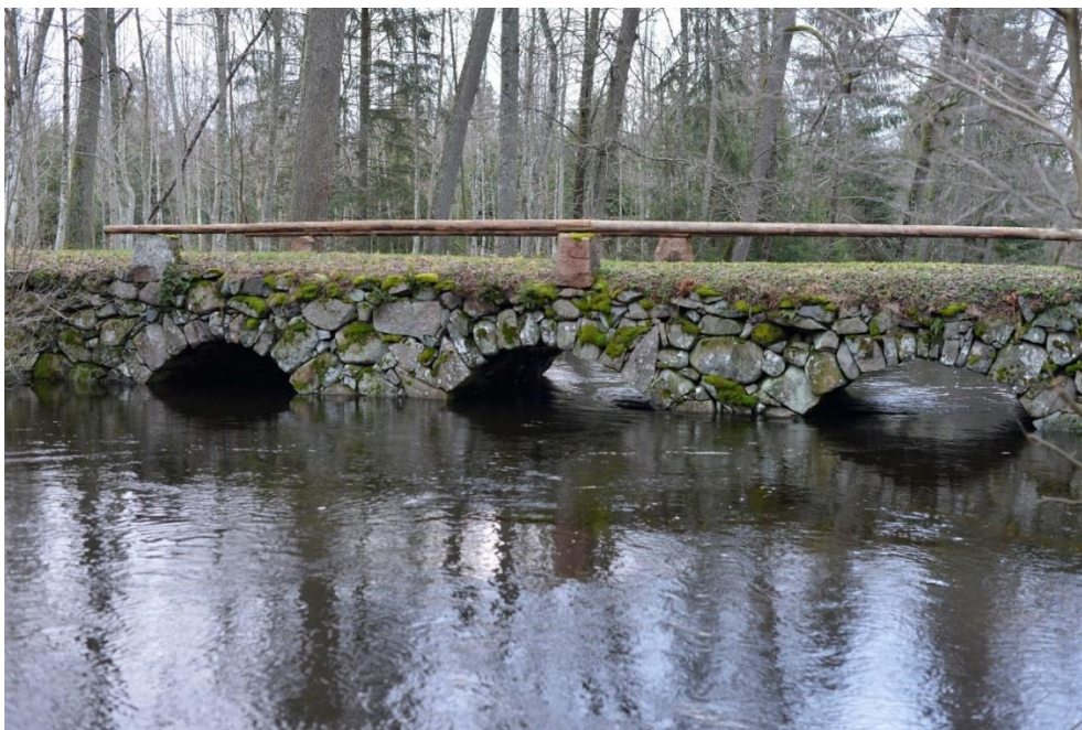
Figur 18. Valvens dimensioner har mätts upp, se figur 18. Brovalven utgör en bestämmande sektion vid högflöden och valven kan också lätt sättas igen vilket snabbt förvärrar situationen.
