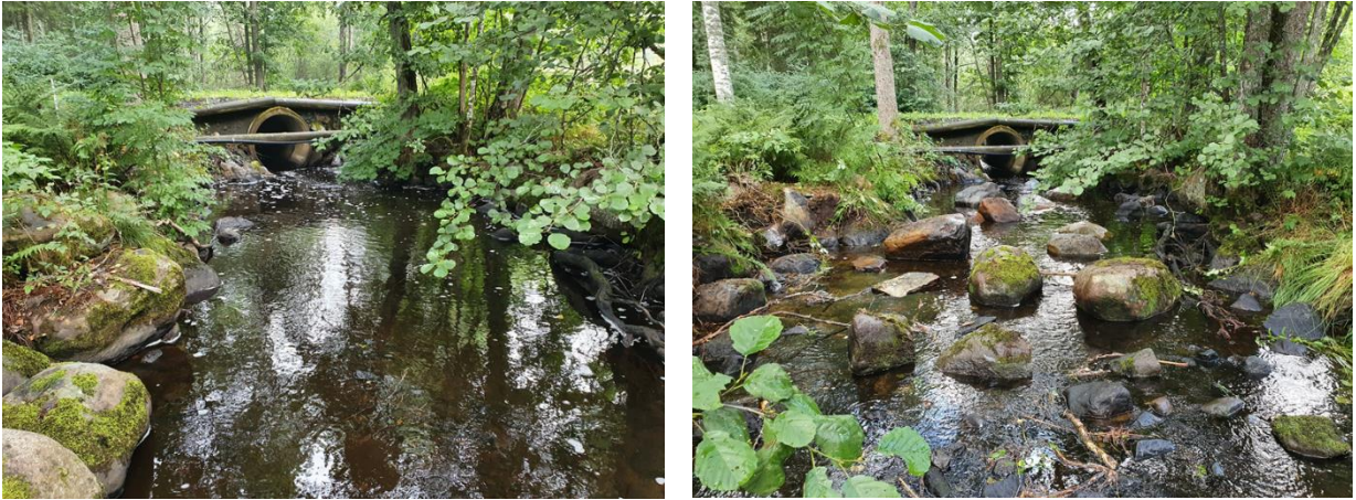
Figur 19. En vägtrumma i Bodanäsaån som skapade ett partiellt vandringshinder. Området nedanför biotopvårdades för hand sommaren 2022 för att höja nivån i trumman (tröskling). Foto: T. Nydén.
