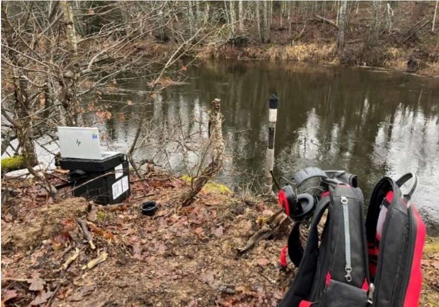
Figur 14. Flera av Emåförbundets mätstationer byttes ut under 2025 p.g.a. den pågående nedsläckningen av 2G/3G-nätet. De nya stationerna kommunicerar via 4G. Foto: J. Nilsson.
